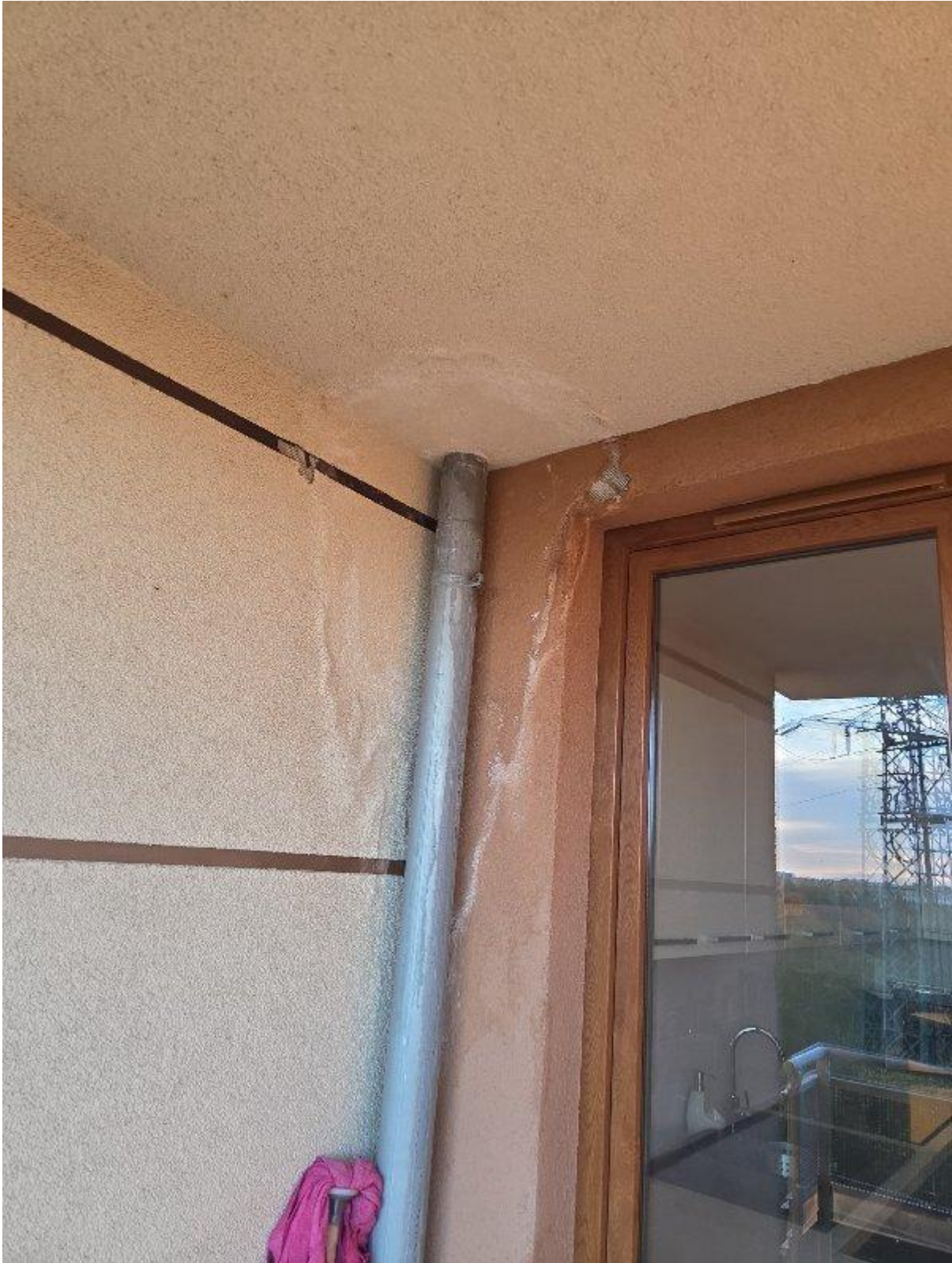
Fot. 1 - Występuje duży przeciek w miejscu przejścia pionu rury spustowej przebiegającej z dachu.
