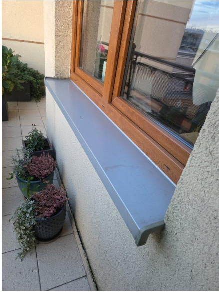
Fot. 25 - Na balkonie parapet okienny osadzony w poziomie - brak poprawnych spadków
