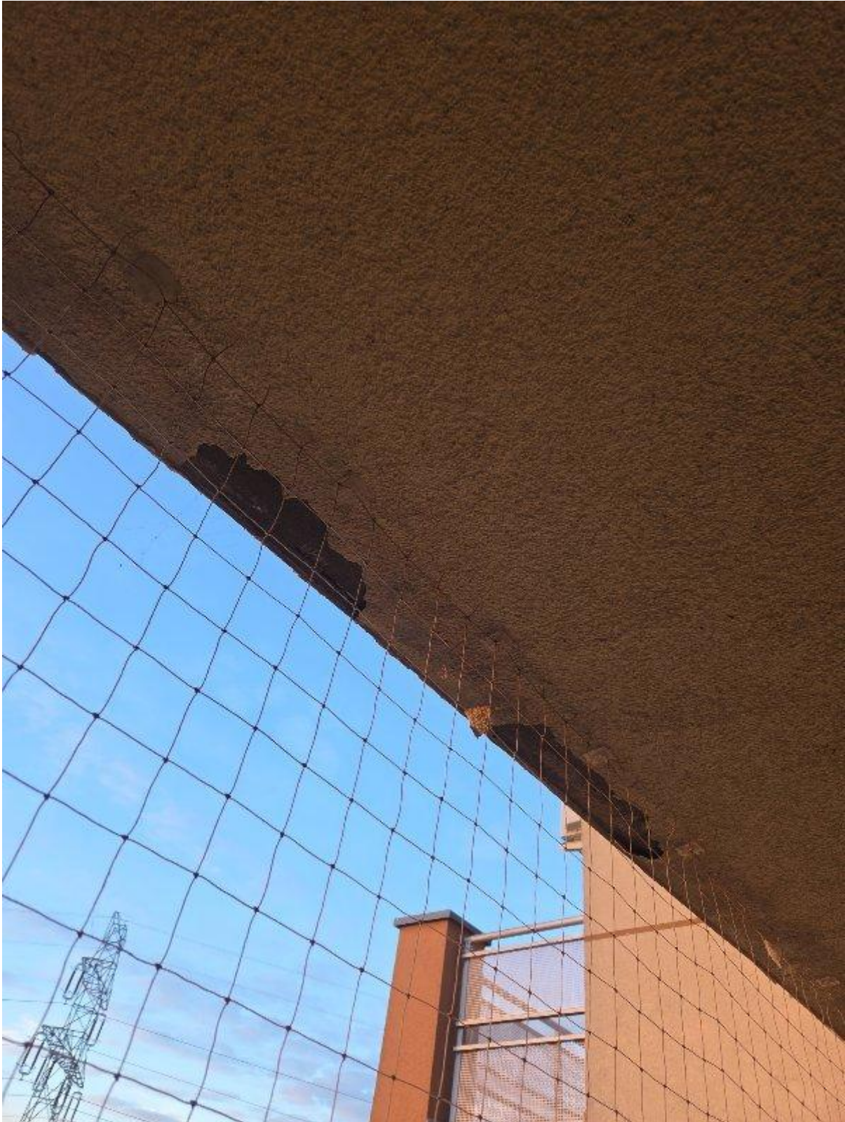
Fot. 7 - Występują ubytki wypraw tynkarskich.
