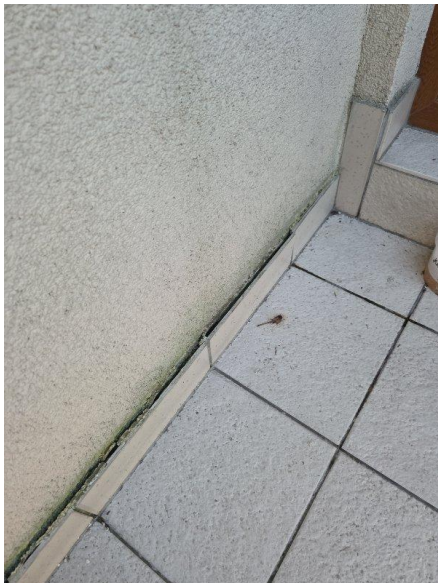
Fot. 19 - Całkowicie odspojony cokolik z płytek ceramicznych
