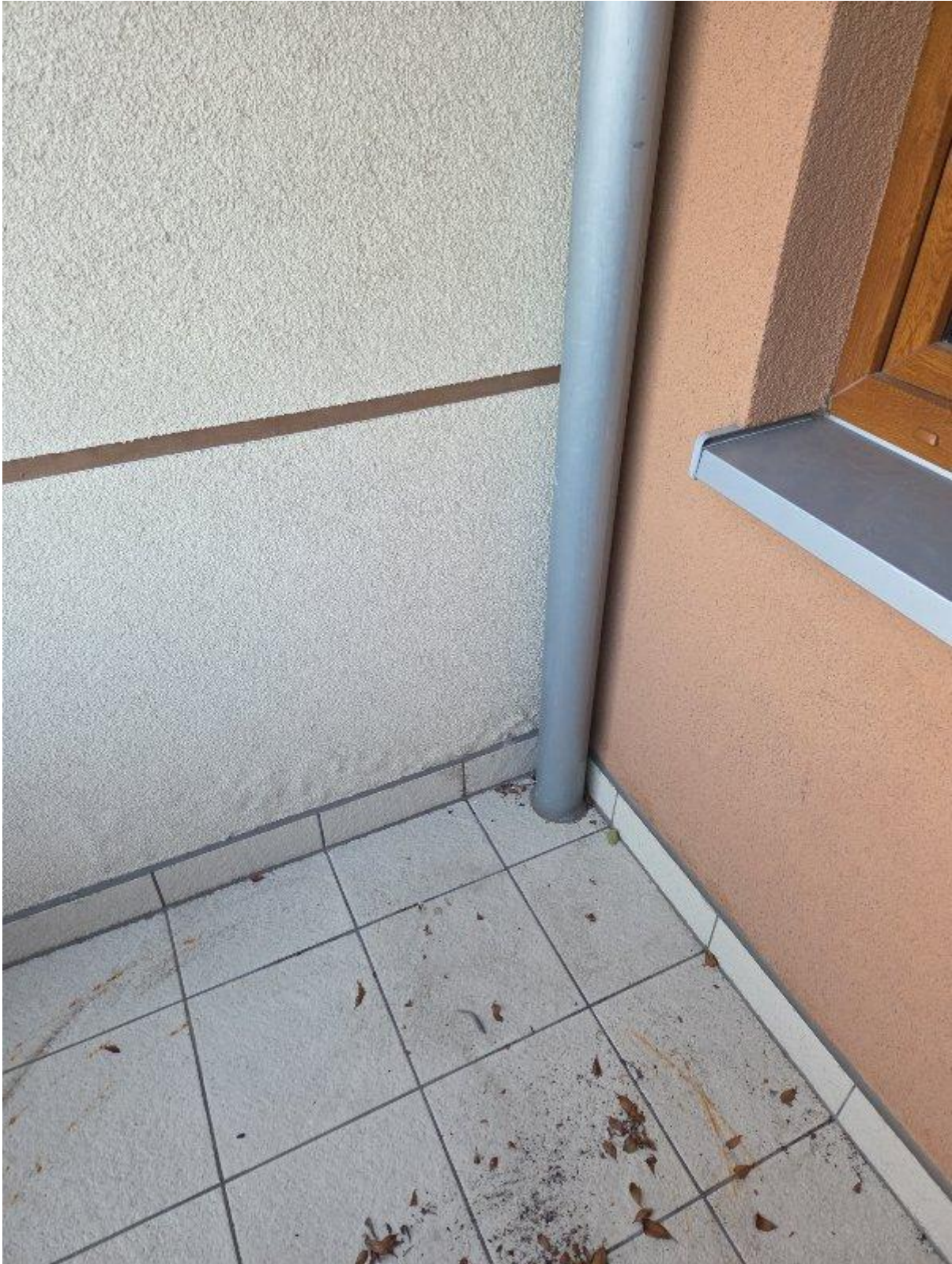
Fot. 10 - Miejsce przejścia rury spustowej przebiegającej z dachu przez płytę balkonową. Na ścianach widoczna napęczniała powłoka tynkarska.
