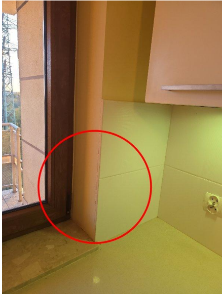
Fot. 5 - W pomieszczeniu kuchni występuje zawilgocenie w ościeżu okiennym oraz odpojenie płytek od ściany przy oknie
