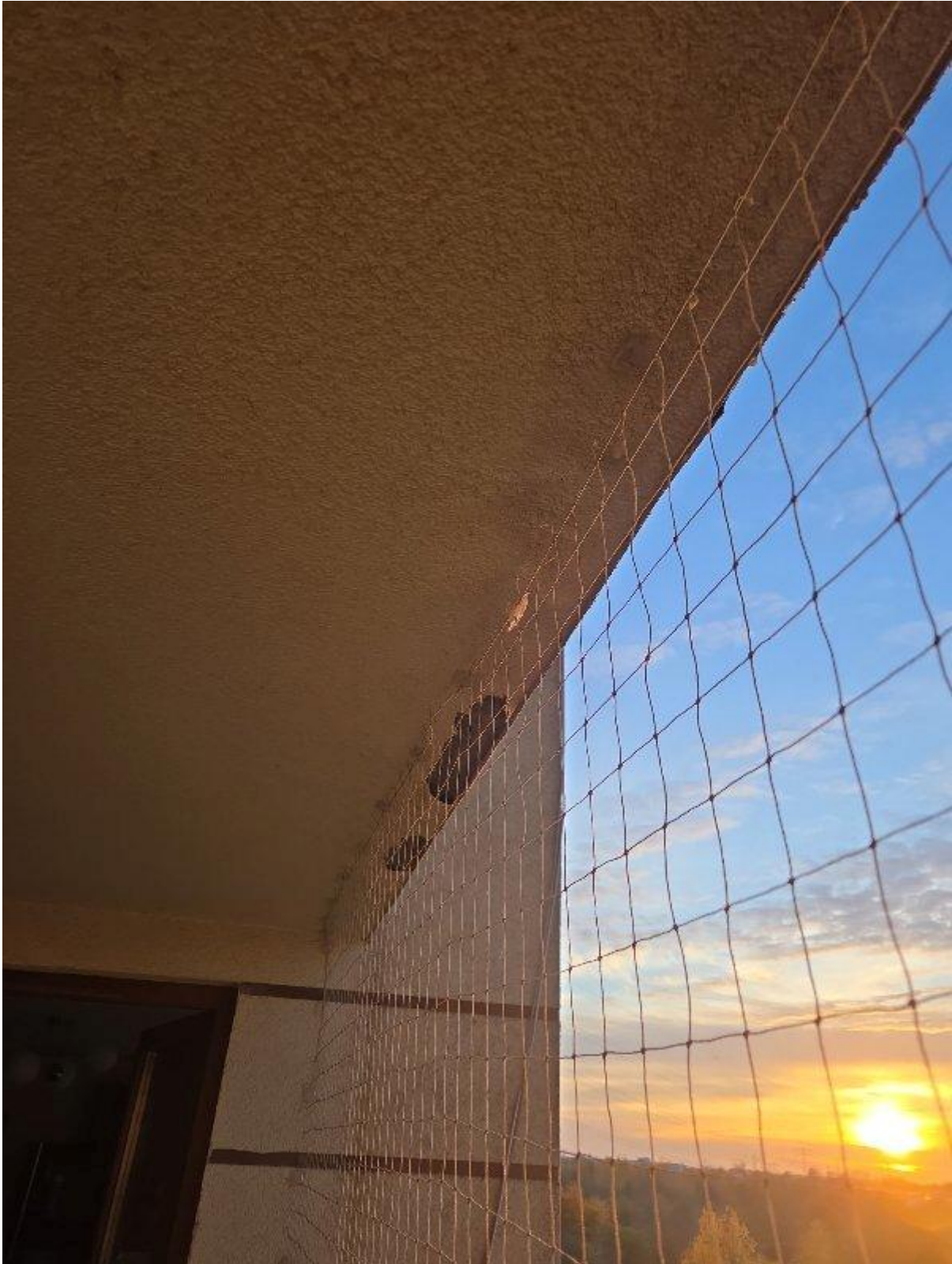
Fot. 6 - Widoczne ślady zacieków oraz złuszczone tynki na krawędzi sufitu - spód płyty balkonu powyżej
