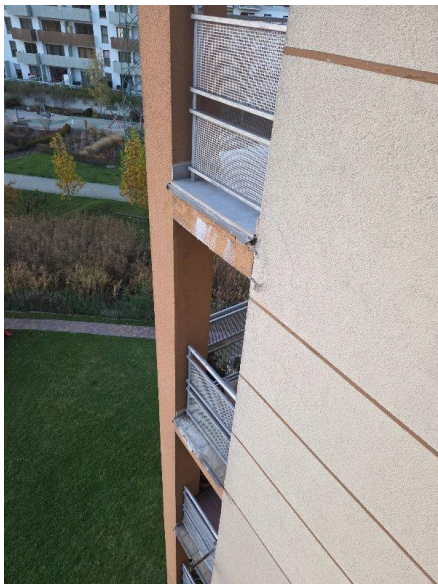
Fot. 23 - Na sąsiednich balkonach degradacja wypraw elewacyjnych.
