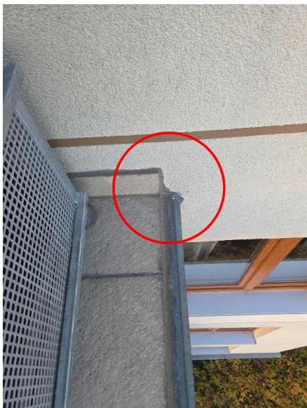
Fot. 12 - W narożniku obróbka jest odgięta do góry lecz nie wcięta w ścianę.
