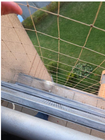
Fot. 8 - Na krawędzi balkonu duże wysolenie na skutek ściekania wody z balkonu powyżej
