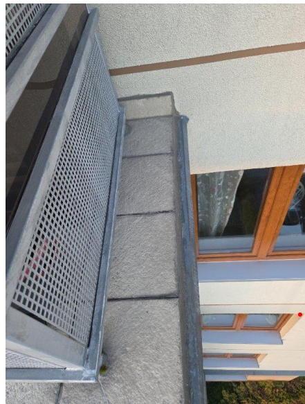
Fot. 13 - W narożniku zewnętrznym płytki ceramiczne odspojone i podniesione. Poniżej znajduje się zaciek na policzku balkonu.
