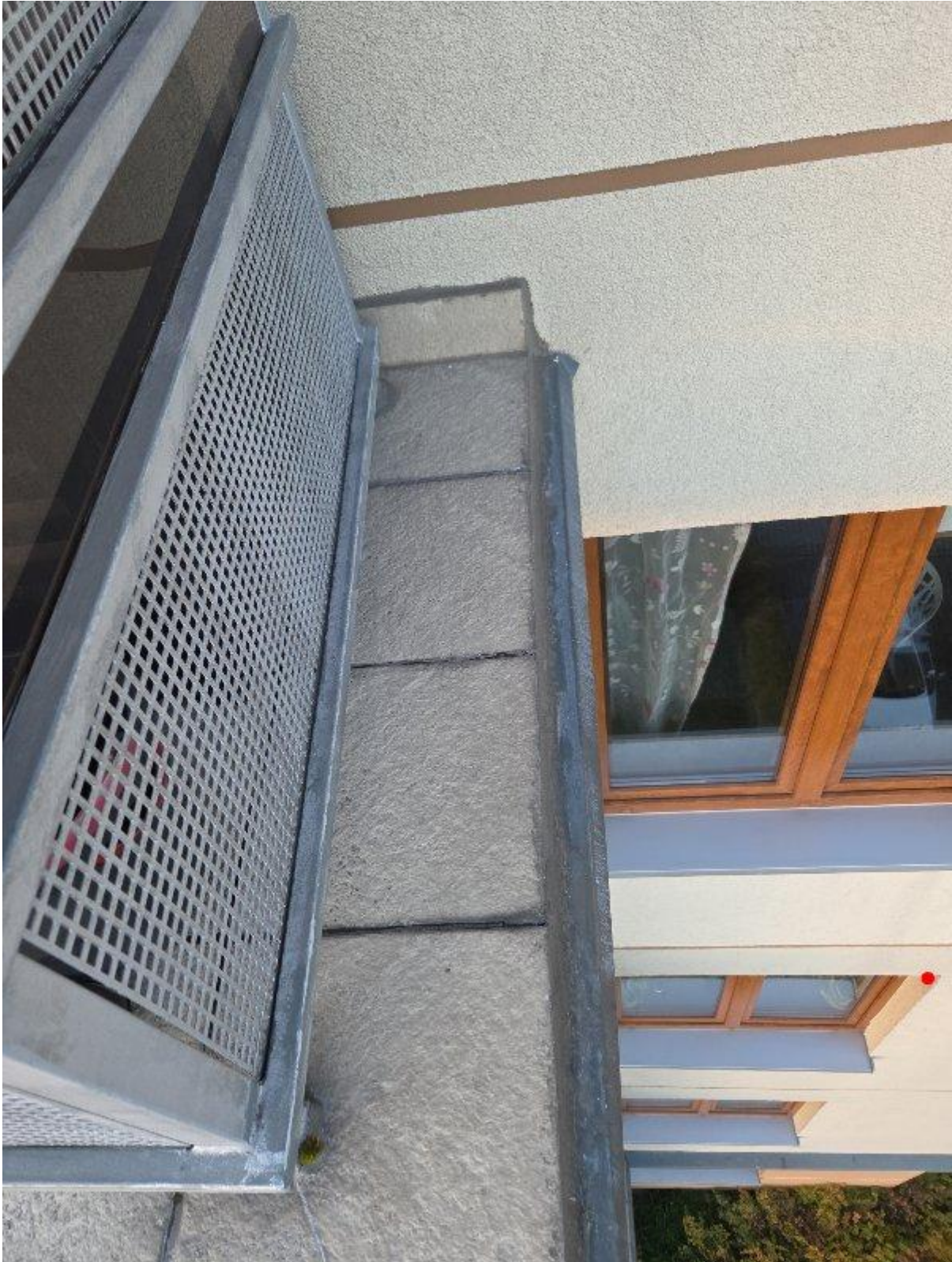
Fot. 13 - W narożniku zewnętrznym płytki ceramiczne odspojone i podniesione. Poniżej znajduje się zacieki na policzku balkonu.
