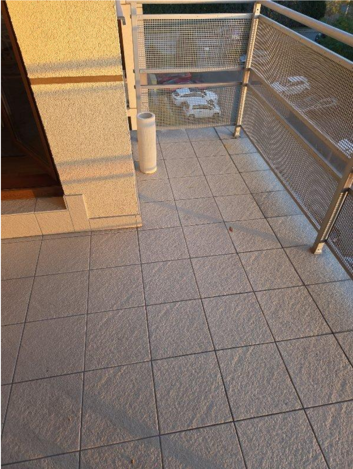
Fot. 4 - Głuche płytki dwóch rzędach wzdłuż pasa okapowego oraz częściowo na trzecim rzędzie.
