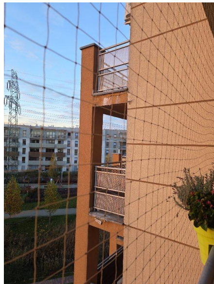
Fot. 9 - Widok na balkony sąsiedniej klatki - również występują uszkodzenia elewacji oraz zacieki na policzkach balkonów
