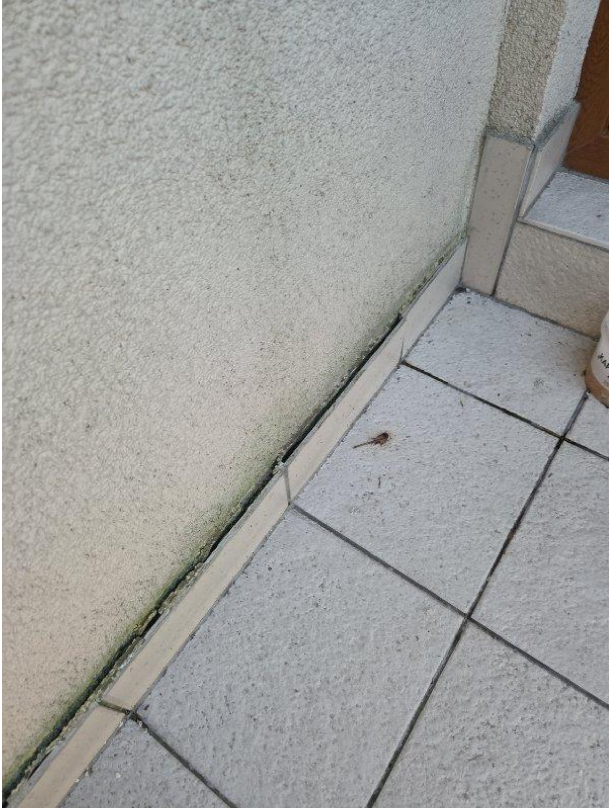
Fot. 19 - Całkowicie odspojony cokolik z płytek ceramicznych
