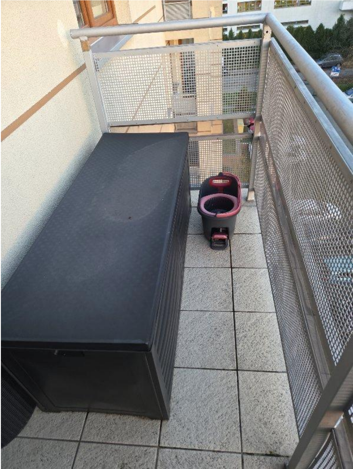
Fot. 14 - Głuche płytki w dwóch rzędach wzdłuż okapu
