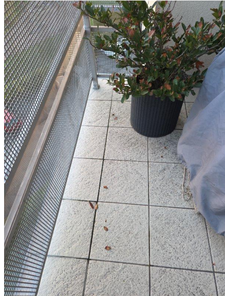
Fot. 15 - Widoczne zawilgocenia spoin między płytkami
