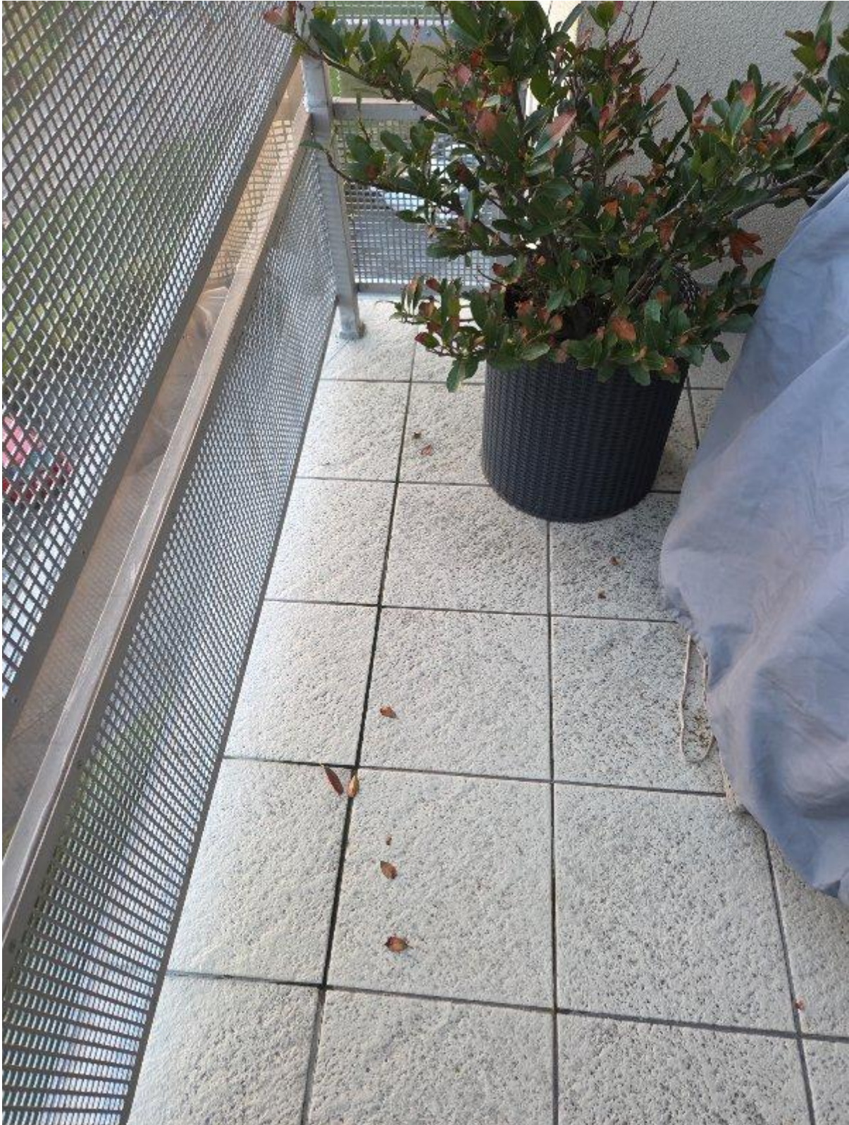
Fot. 15 - Widoczne zawilgocenia spoin między płytkami
