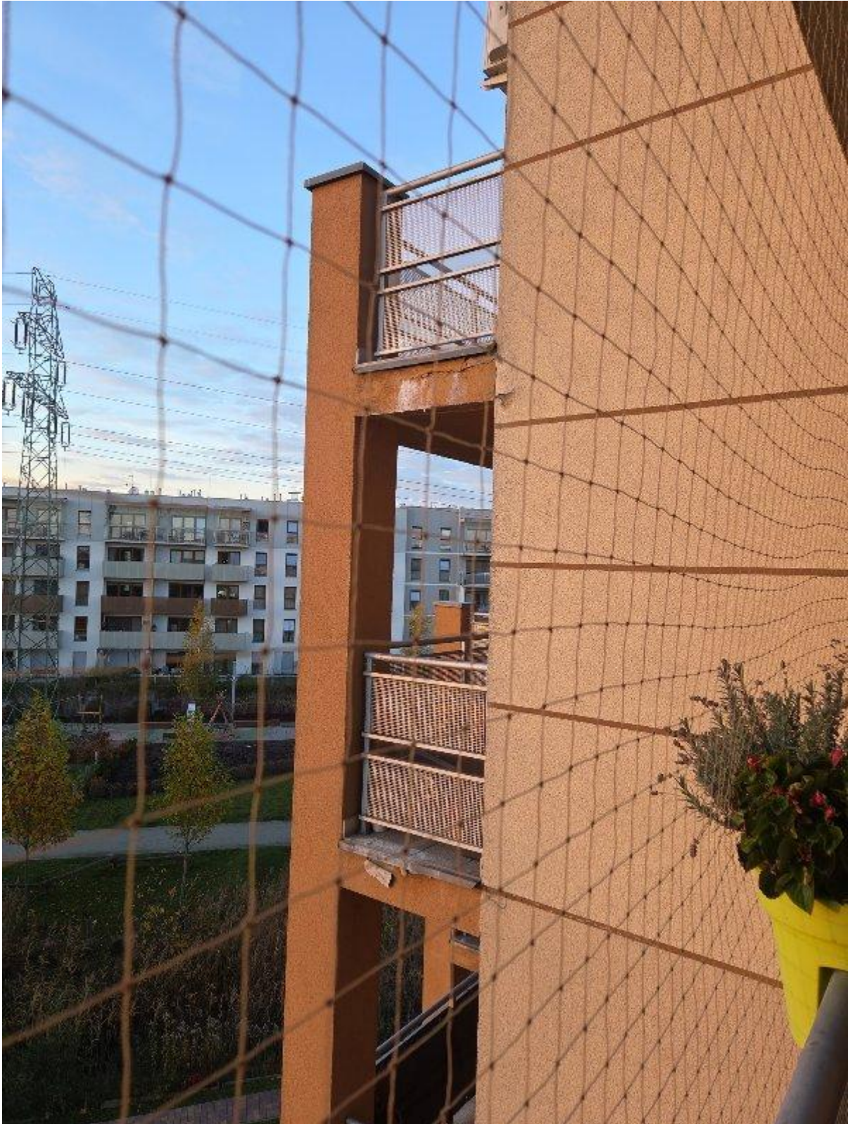
Fot. 9 - Widok na balkony sąsiedniej klatki - również występują uszkodzenia elewacji oraz zacieki na policzkach balkonów
