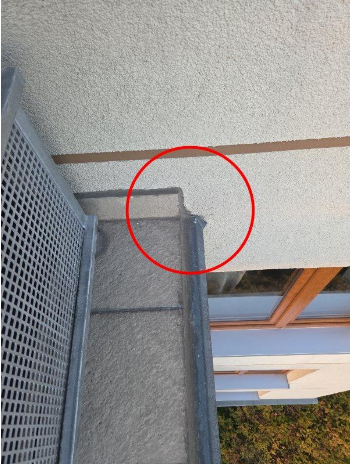
Fot. 12 - W narożniku obróbka jest odgięta do góry lecz nie wcięta w ścianę.
