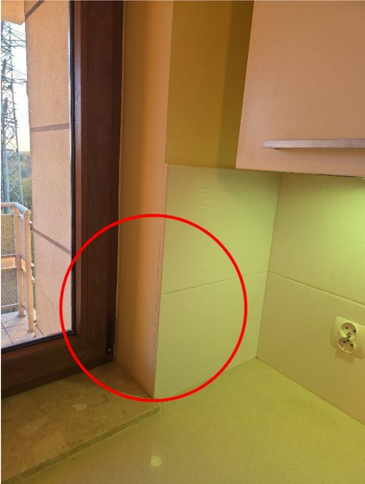
Fot. 5 - W pomieszczeniu kuchni występuje zawilgocenie w ościeżu okiennym oraz odpojenie płytek od ściany przy oknie
