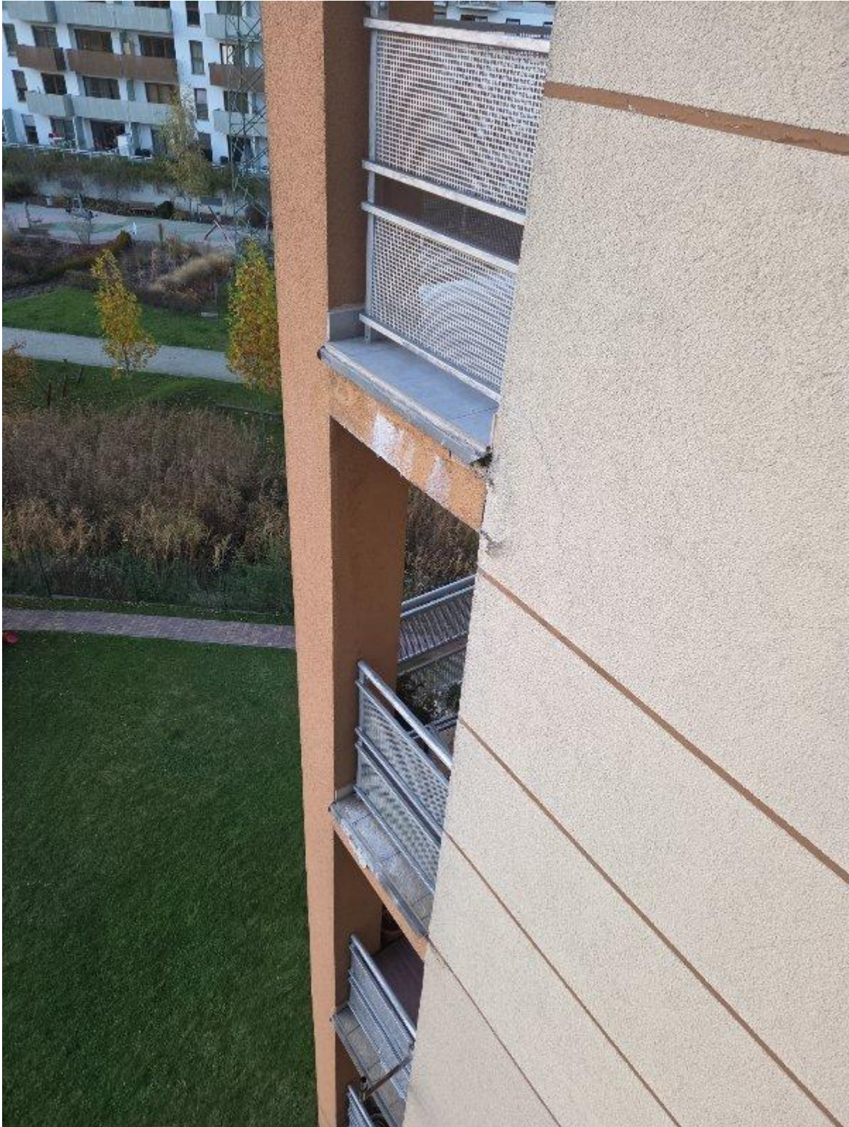
Fot. 23 - Na sąsiednich balkonach degradacja wypraw elewacyjnych.
