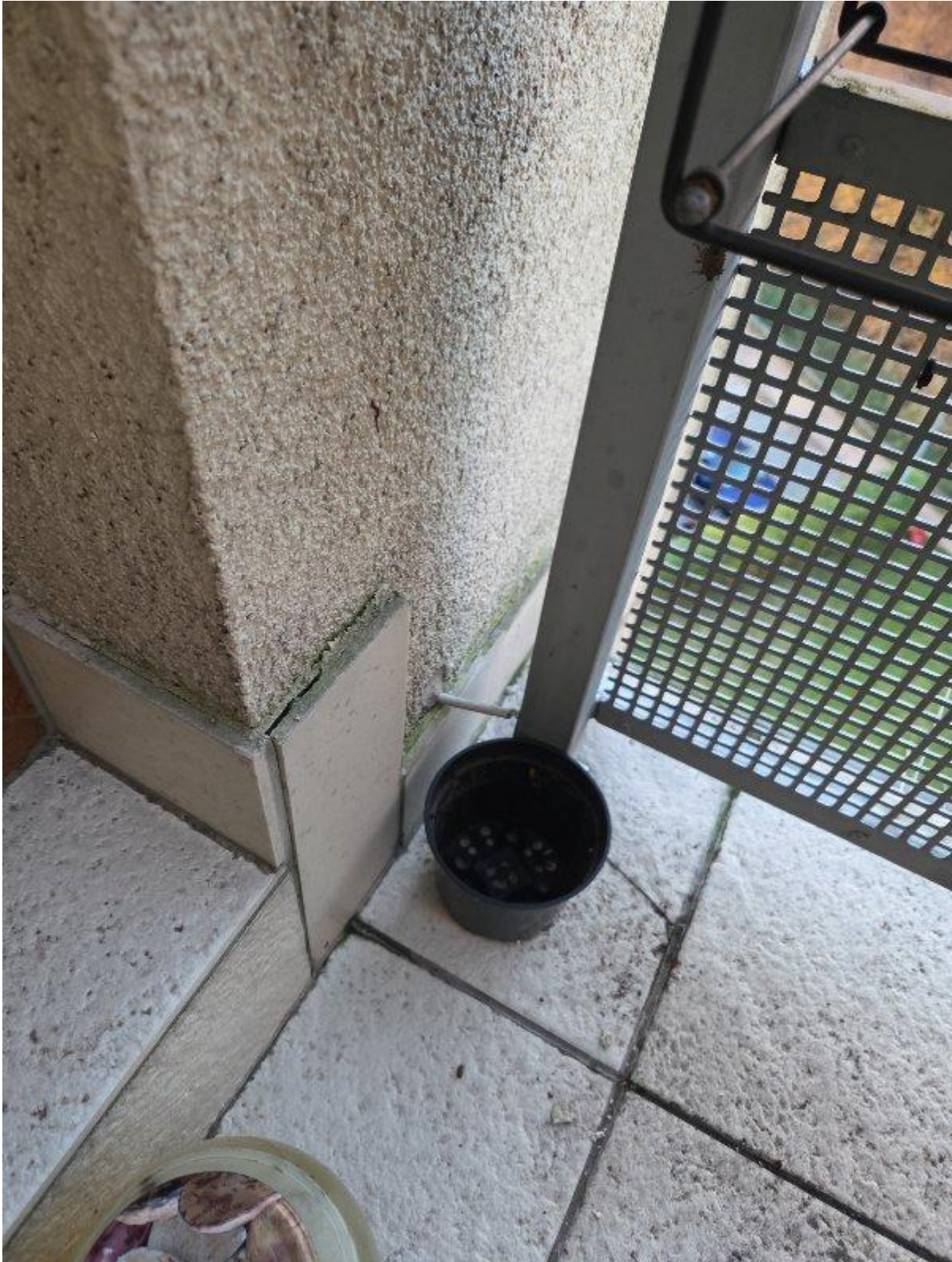
Fot. 26 - Pęknięcia płytek oraz odspojenie cokołu
